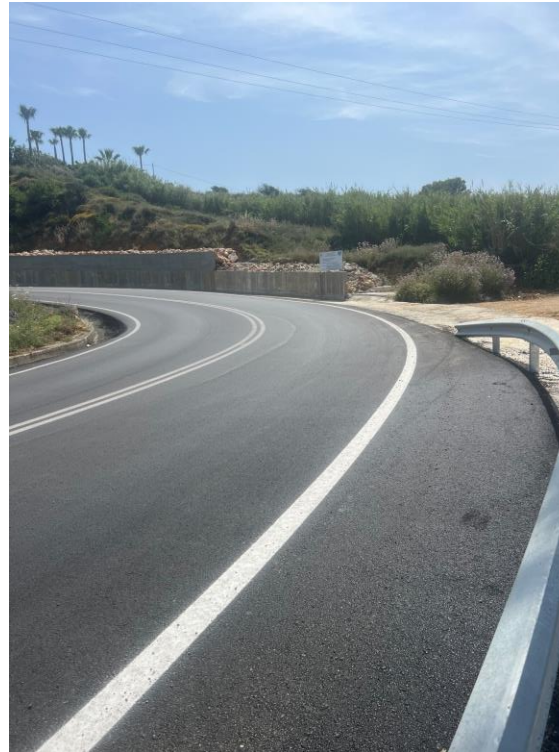
ΕΠΕΙΓΟΥΣΕΣ ΕΡΓΑΣΙΕΣ ΑΠΟΚΑΤΑΣΤΑΣΗΣ ΖΗΜΙΩΝ ΣΤΑ ΟΔΙΚΑ ΤΜΗΜΑΤΑ Β.Ο.Α.Κ.- ΕΠΙΣΚΟΠΗ - ΜΥΡΙΟΚΕΦΑΛΑ - ΌΡΙΑ ΝΟΜΟΥ ΧΑΝΙΩΝ, ΑΡΓΥΡΟΥΠΟΛΗ - ΌΡΙΑ ΝΟΜΟΥ ΧΑΝΙΩΝ
