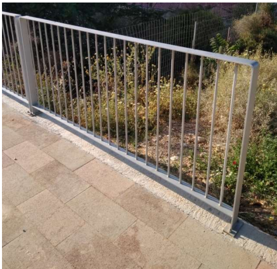
Εικ.34 Μεταλλικές σχάρες
