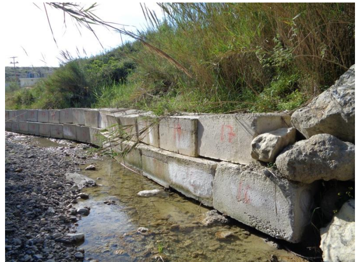
Φ 24. Κίνδυνος αστοχίας της προσωρινής αντιδιαβρωτικής προστασίας
