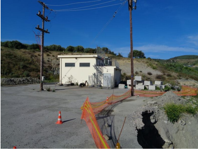
Φ 17. Ολίσθηση του επιχώματος στο φρεάτιο συλλογής στραγγιστηρίων
