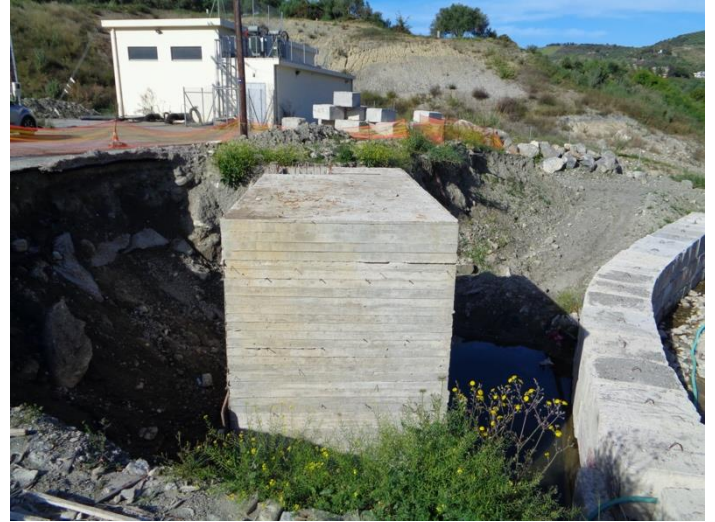
Φ 18. Ολίσθηση του επιχώματος στο φρεάτιο συλλογής στραγγιστηρίων
