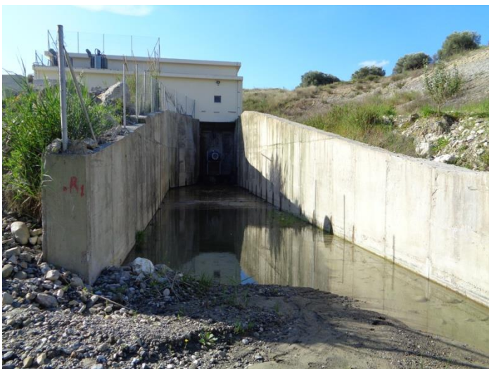
Φ 11. Αντλιοστάσιο – Έξοδος αγωγού εκτροπής
