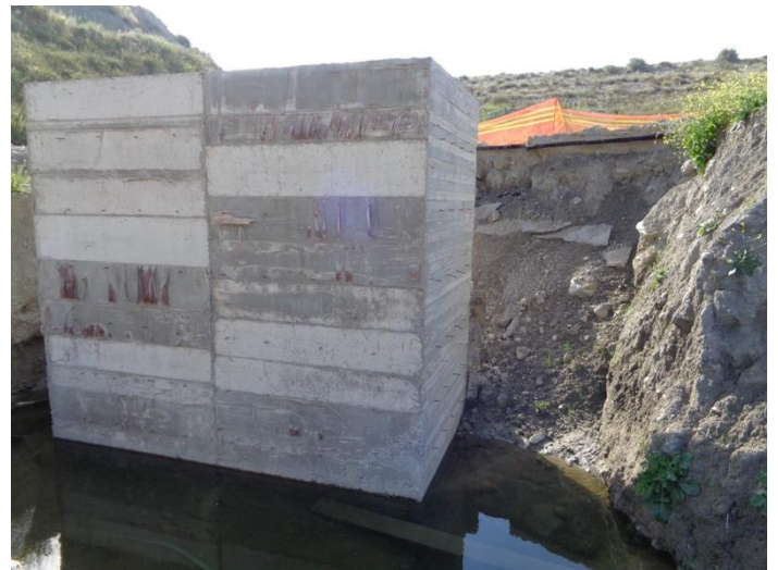
Φ 20. Ολίσθηση του επιχώματος στο φρεάτιο συλλογής στραγγιστηρίων
