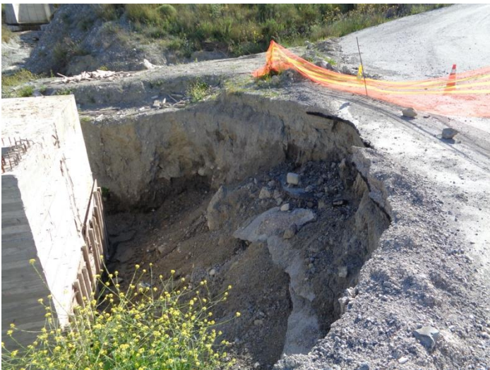
Φ 19. Ολίσθηση του επιχώματος στο φρεάτιο συλλογής στραγγιστηρίων
